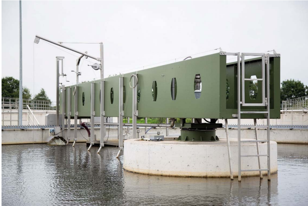
Nachklärbecken und Rundräumer
