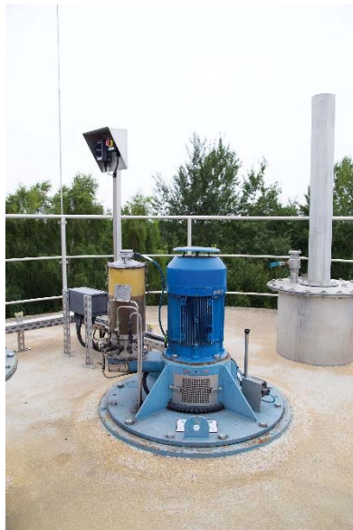
Rührwerk Faulturm mit Zentralschmieranlage
